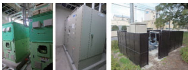
ヒートポンプユニット
