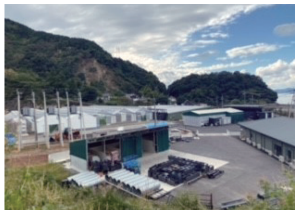
木質バイオマス熱電併給プラント及び周辺施設（建設中）
