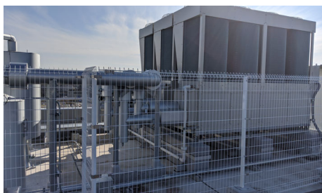
イオンモール上尾の断熱・空調設備
