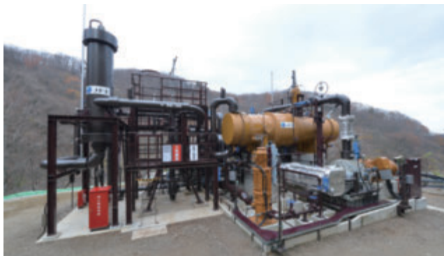
設置されているバイナリー発電設備
