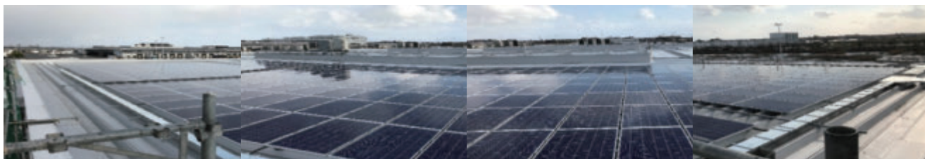
太陽光パネル
