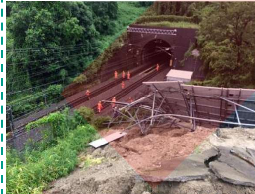
新幹線近くの斜面上部に設置された太陽光発電施設が崩落した事例
