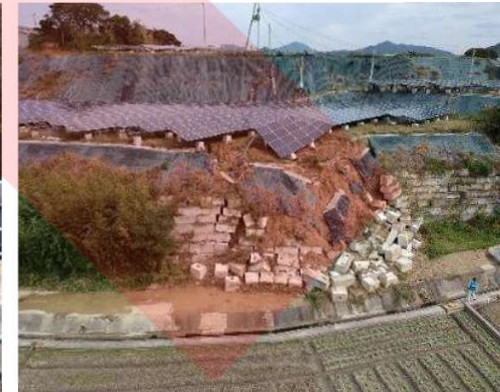
法面保護工が崩れて流出した事例
